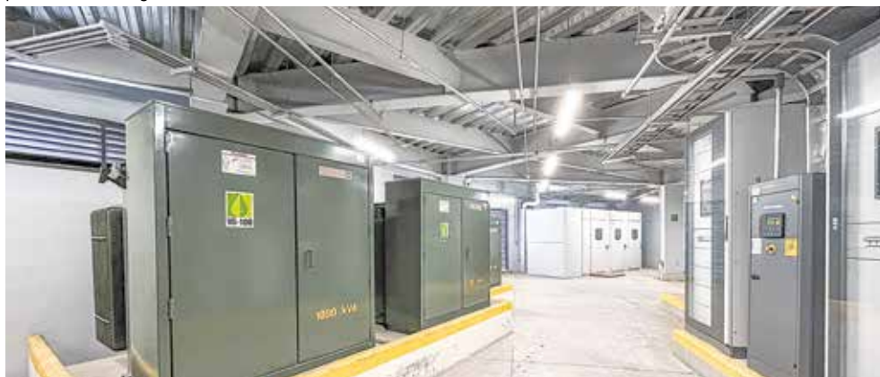
El cuarto eléctrico cuenta con tres plantas de emergencia
