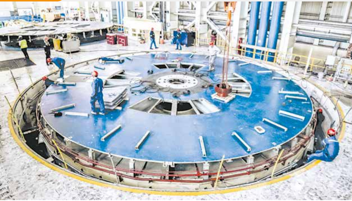
Se equipan tres centrales con una capacidad de 46.4 MW cada una
