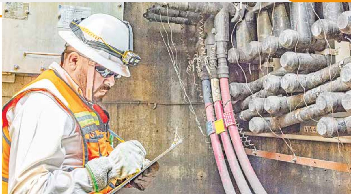
La norma dice que los cables deben tener entre uno y otro un mínimo de dos metros de separación, pero casi nunca se consigue
